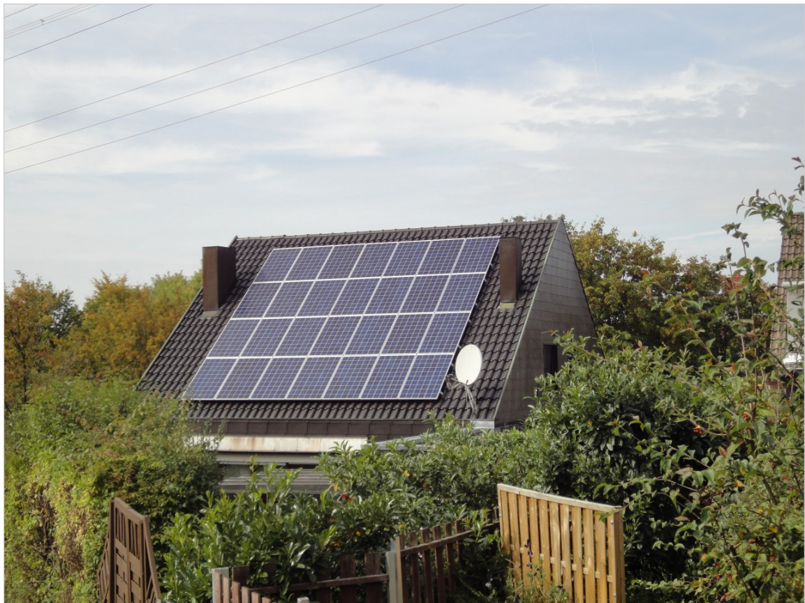
Abb. 2 – Photovoltaikanlage, Bild: Manfred Richey
