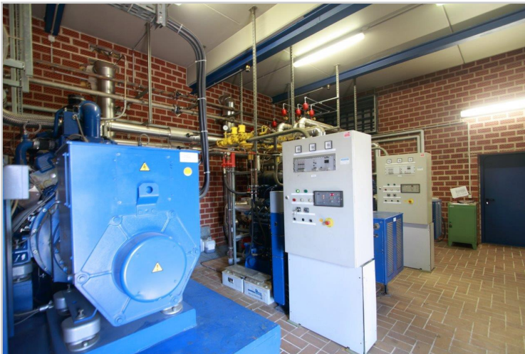
Abb. 3 - Kläranlage in Bad Oeynhausen Bild: www.energieagentur.nrw.de
