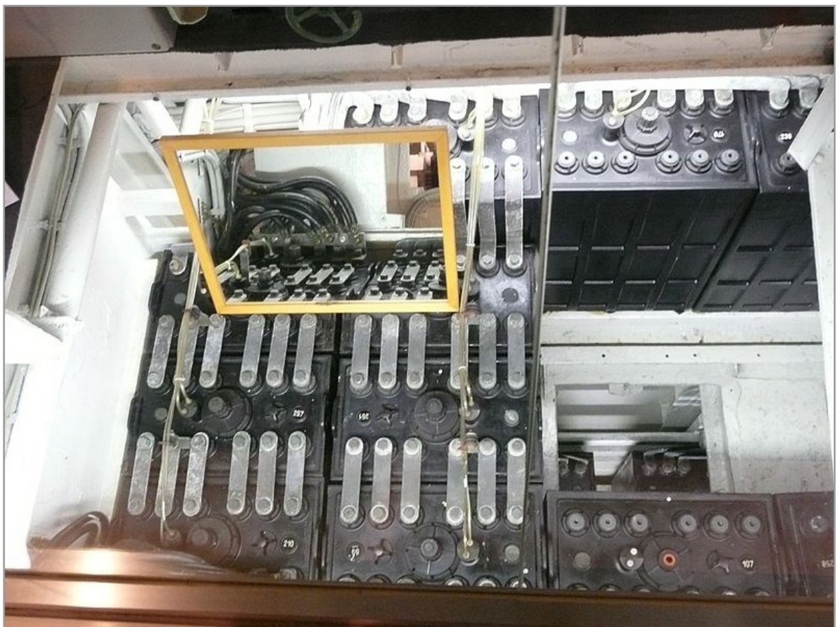
Abb. 3 - Blick in einen teilweise bestückten Akkumulatorraum des Typ XXI U-Bootes Wilhelm Bauer, 19. August 2008, Quelle: de.wikipedia.org, Autor: WerWil .
