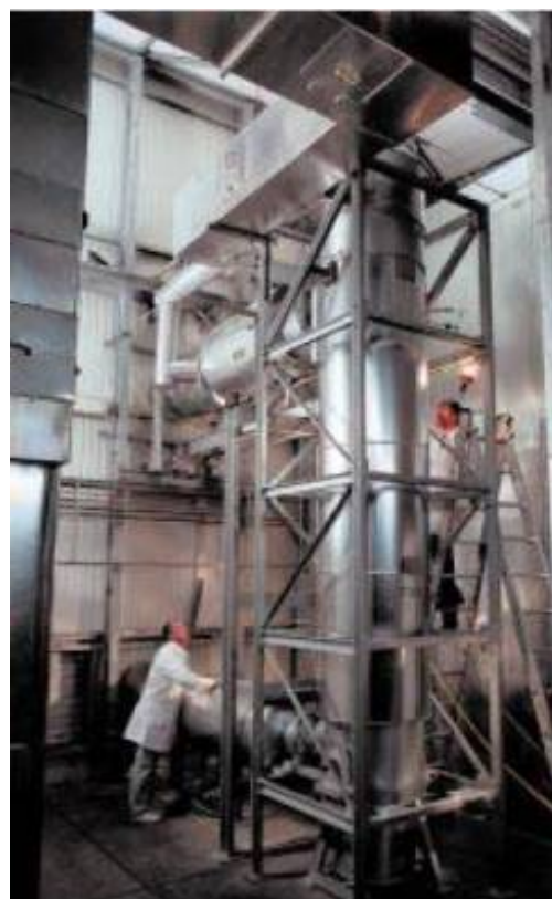
Abb. 6: Vorwärmer (oben links) und Reaktor der Anlage VERENA.
