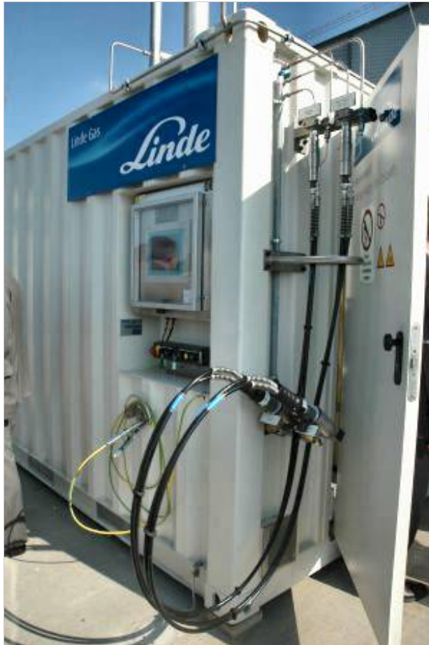
Oben: H 2 -Tankstelle. Bilder mit freundlicher Genehmigung von http://www.h2gate.com , Barbara Makowka
